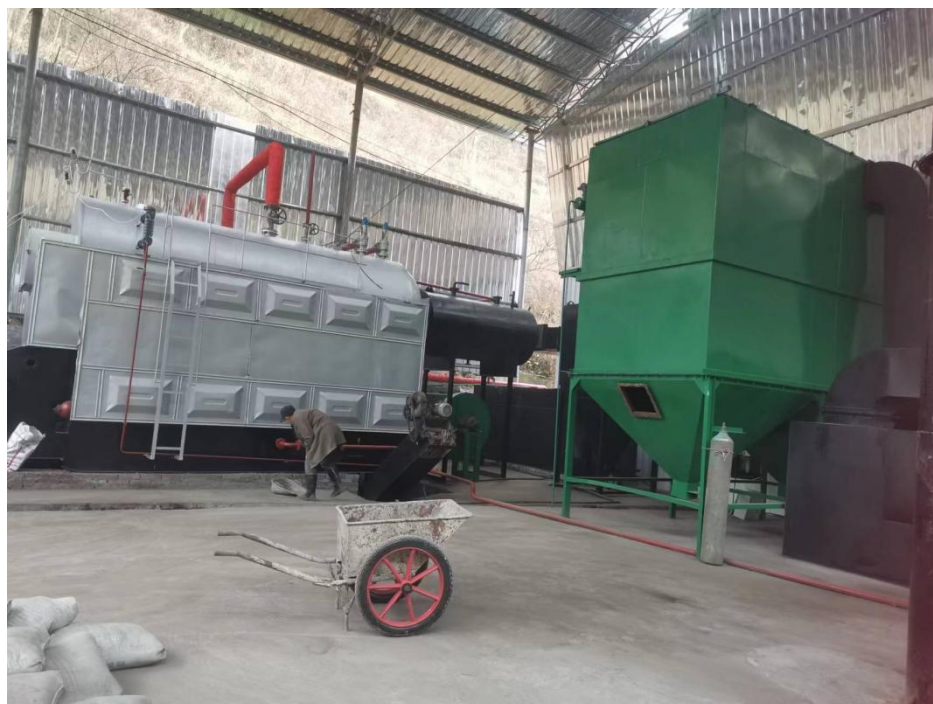
锅炉除尘设备
