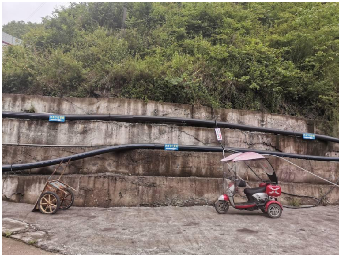
废水回用管道
